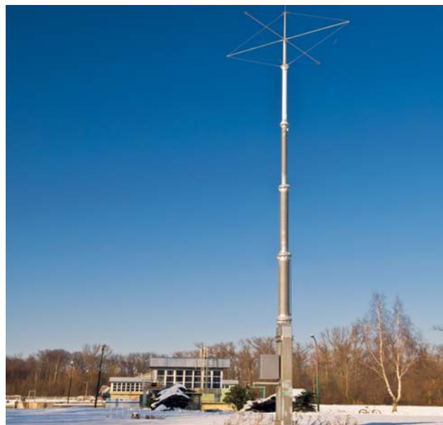
Vysílač referenční stanice DGPS v Obříství u Mělníka
