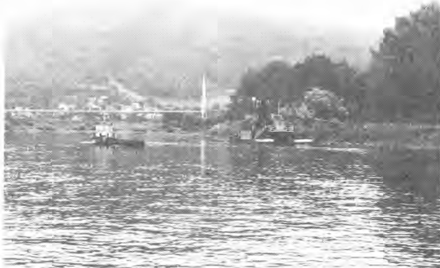
Obr. 1 – Elevátor bagrovací soupravy na českém úseku Labe pod Ústím nad Labem
