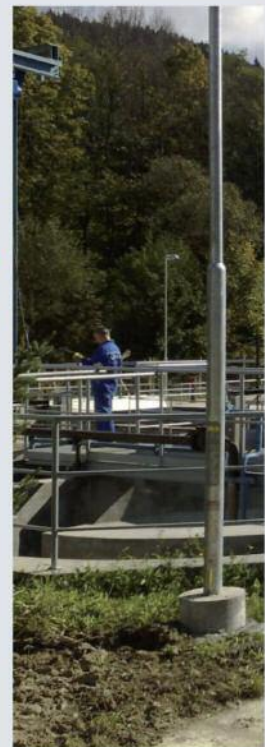
Čistička odpadních vod Valašské Klobouky, Česká republika
