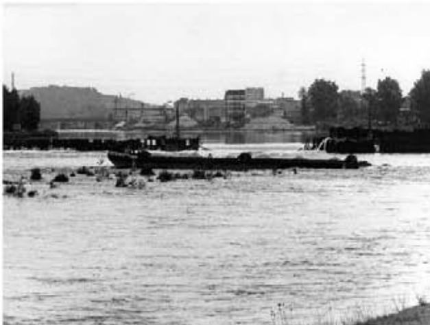
Obr. 1. Hradlový jez na Vltavě v Praze-Tróji po havárii: Střední pole má hradlový uzávěr zcela zničen, pravé silně poškozen, přičemž levé pole bylo zajímkováno v rámci opravy podjezí
