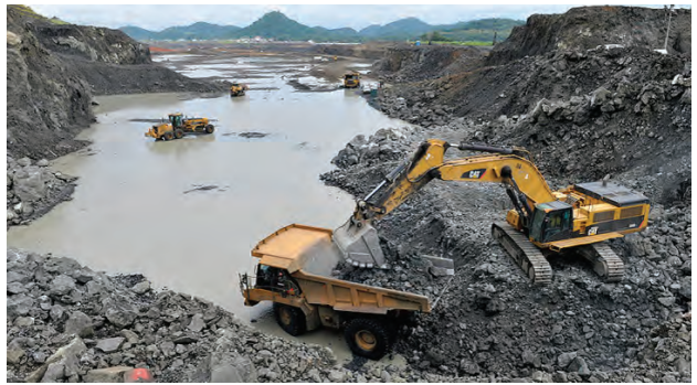
Výstavba plavebního kanálu k nové plavební komoře na pacifické straně Panamského průplavu
