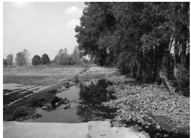
Kozárovice - destrukce hráže
