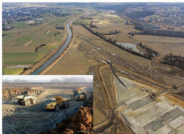
U města Ratiboř probíhá výstavba nádrže Racibórz Dolny, která je klíčovou investicí pro plavební napojení ČR na oderskou vodní cestu, zdroj: www.programodra.pl
