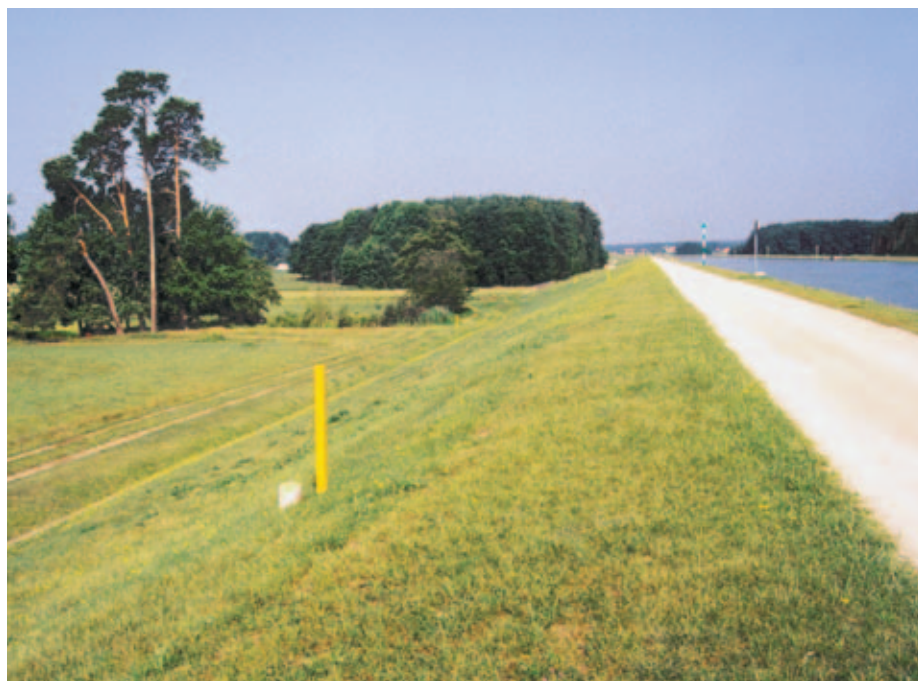
Úsek průplavu Mohan–Dunaj, který je vedený v mírném násypu s hladinou nad terénem. Na vzdušných svazích tělesa je pečlivě udržovaný travní kryt, což usnadňuje kontrolu případných průsaků.
