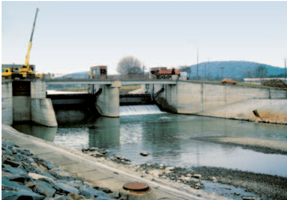
Nedávno vybudovaný segmentový jez na Bečvě v Hranicích byl navržen již s ohledem na požadavky vodní cesty. Projektant počítal s mírným zvýšením vzdutí.
