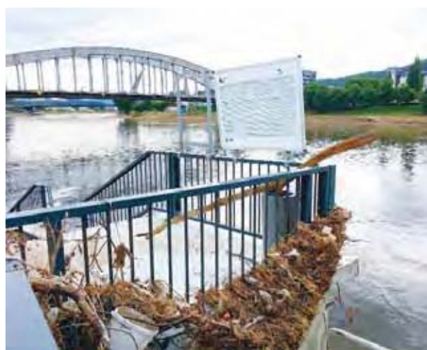
Přístaviště Ústí nad Labem – centrum po průchodu povodní
