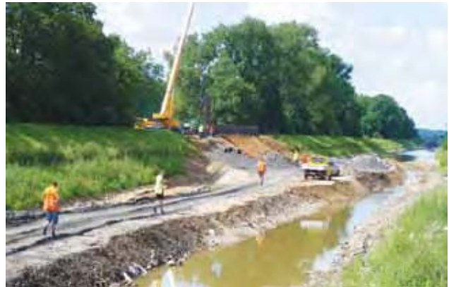
Porucha pravobřežní hráze mezi Lužcem a Vraňany (km 8,35) – postup opravy 13. 8. 2013
