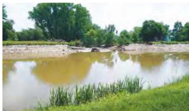
Porucha pravobřežní hráze nad plavební komorou Hořín – stav po povodni 8. 6. 2013
