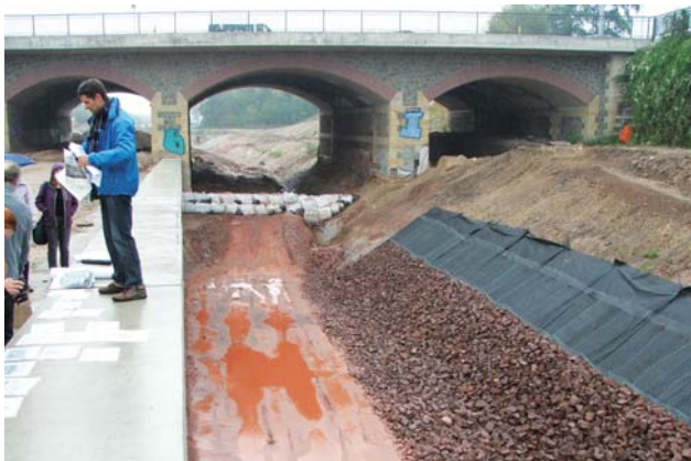
Propojení mezi Karl-Heine-Kanal a Lindenauer Hafen ve výstavbě (září 2014 - exkurze P&S, a.s.)
