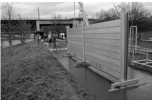
Protipovodňové hradidlové hrazení firmy Alukönigfra Instahl s. r. o.
