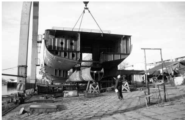
obr. 4. Zde už je část zádě MS Helenic mezi žebry 15 až 23 vestavěna do tělesa.
