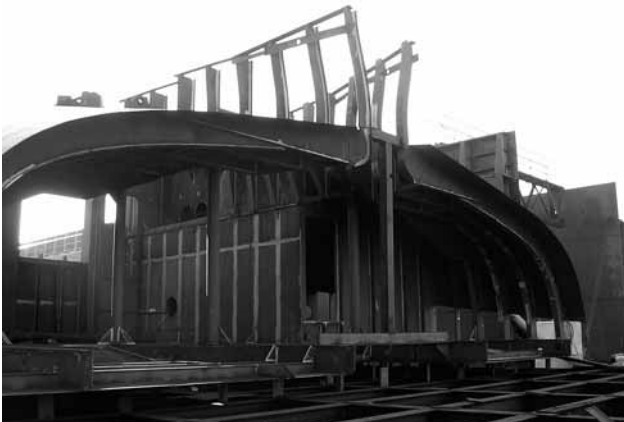
obr. 3. A takto probíhala stavba zádě MS Helenic. Loděnice Nova Mělník nepoužívá přípravky (postele) pro stavbu objemových sekcí, čímž se snižují náklady.
