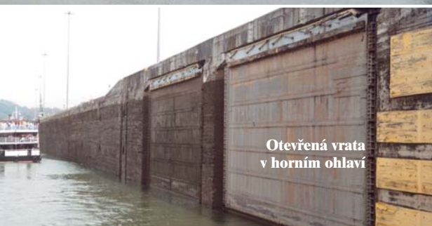
Zdvojená vzpěrná vrata plavebních komor
