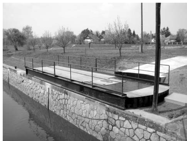
Most souběžně s plavební komorou
