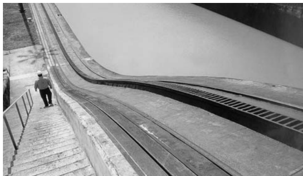
Uprostřed kolejí je uložena litinová ozubnicová lišta pro dobrý tah elektrických lokomotiv. Na vnější straně (vlevo) je pak lišta s podélným žlábkem pro elektrickou trolej.
