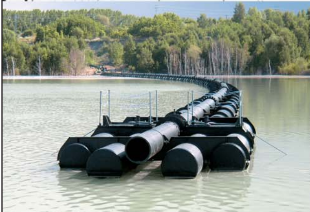
Součástí dodávky plovoucího potrubí je i manipulační jeřábové plavidlo
