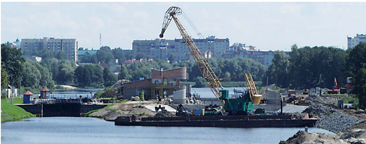
Výstavba plavební komory Trišín probíhala v letech 2009 až 2011. Vlevo původní dřevěná komora před zasypaním Autor: Sergej Izokh
