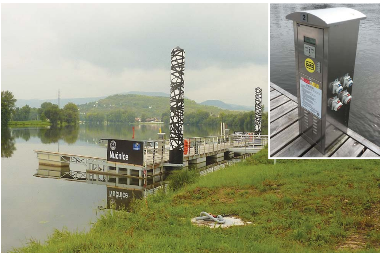
Přístaviště Nučnice - s novými odběrnými sloupky elektřiny a vody
