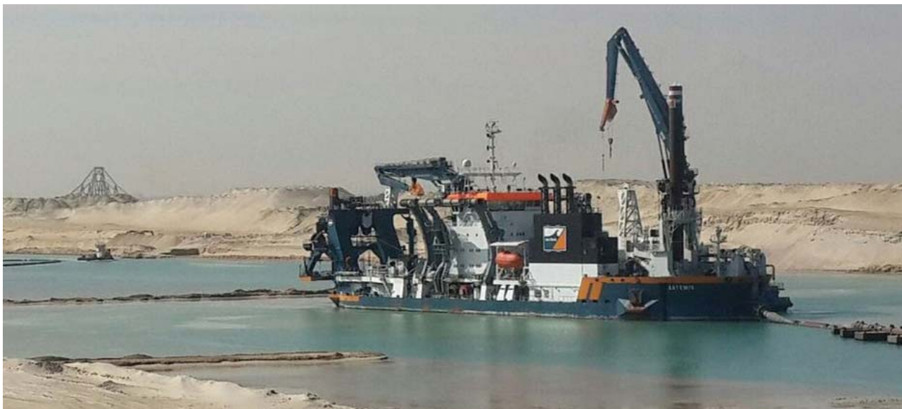
Na stavbu nového průplavu se shromáždila největší stavební technika světa. Foto: DredgingToday.com
