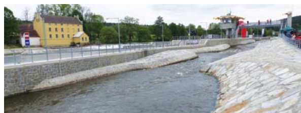
Rybí přechod na jezu Hněvkovice (2017)
