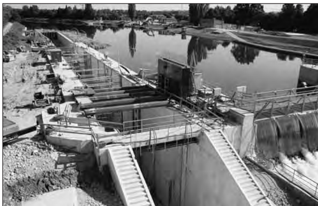
Výstavba plavební komory a ochranného přístavu České Vrbné (v pozadí) Foto: ŘVC ČR
