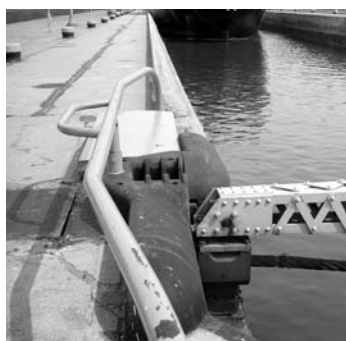
Kotva lana dynamické ochrany zapadne do mohutného kotevního bloku ve zdi plavební komory
