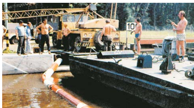
Zkoušky dynamické ochrany vrat plavební komory v Praze-Modřanech
