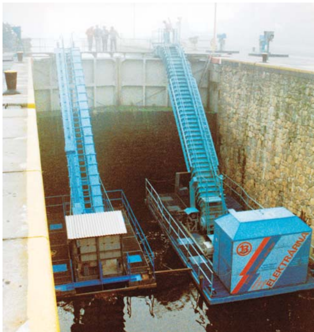
Dvě plovoucí malé vodní elektrárny v malé plavební komoře v Hoříně
