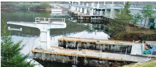
V pozdějším finálním návrhu nebylo dokončeno ani plavební zařízení pro malou plavbu. Na obr. nedostavěná vyrovnávací plavební komora na VD Slapy
