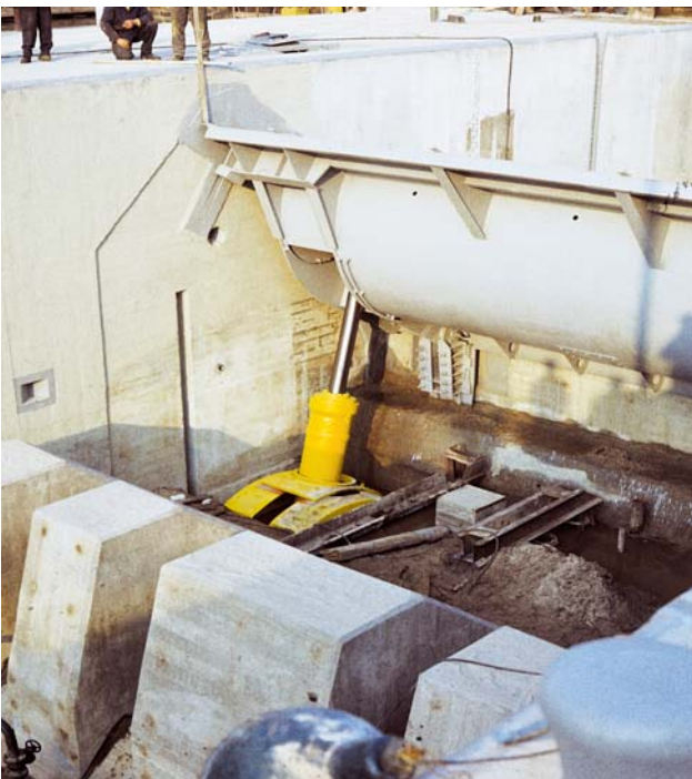
Horní klapková vrata plavební komory Roudnice nad Labem, podpíraná hydraulickým válcem slouží pro přímé plnění ale mohou převádět i povodňové průtoky
