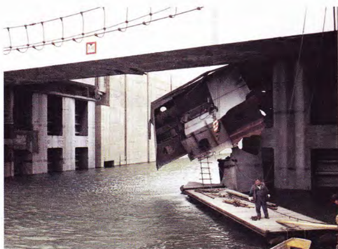
Havarovaná dolní opěrná vrata v levé plavební komoře.
