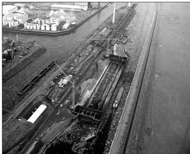
Výstavba plavební komory Niedrig na Labi při vjezdu do přístavu Magdeburg pomůže vyrovnat kolísající hladinu vody
